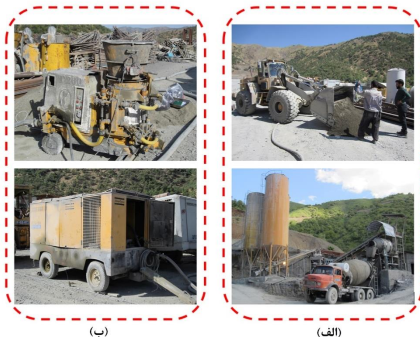
شکل ۵. نمایی از آماده‌سازی (الف) مصالح مصرفی و (ب) دستگاه‌های مورد استفاده برای اجرای شاتکریت
