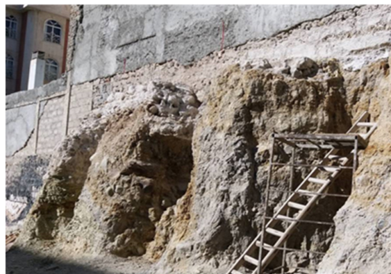
شکل ۲۰. پایدارسازی ضلع غربی گود با دیوار حائل پشت بنددار در خیابان فروغی
