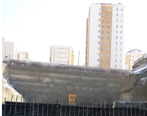
شکل ۲۳. پایدارسازی دیواره شرقی پروژه نگین ولیعصر با سیستم ترکیبی میخ‌کوبی و انکراژ
